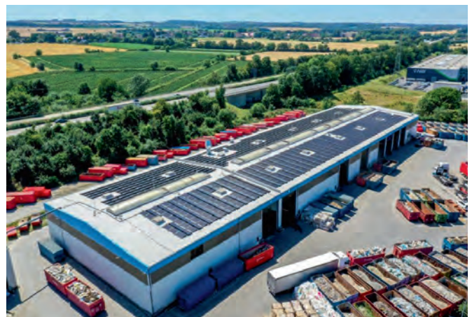
Photovoltaik-Anlage auf dem Dach der BÖRDE Recycling GmbH am Soester Sälzerweg.
