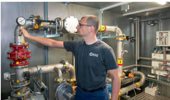
Florian Brinkmann (Meister) überprüft die Gasdruckverhältnisse.
