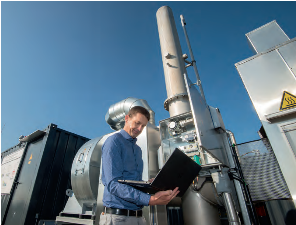
Foto links: Dirk Conrady (Technischer Leiter der ESG) überwacht die Anlagensteuerung.
